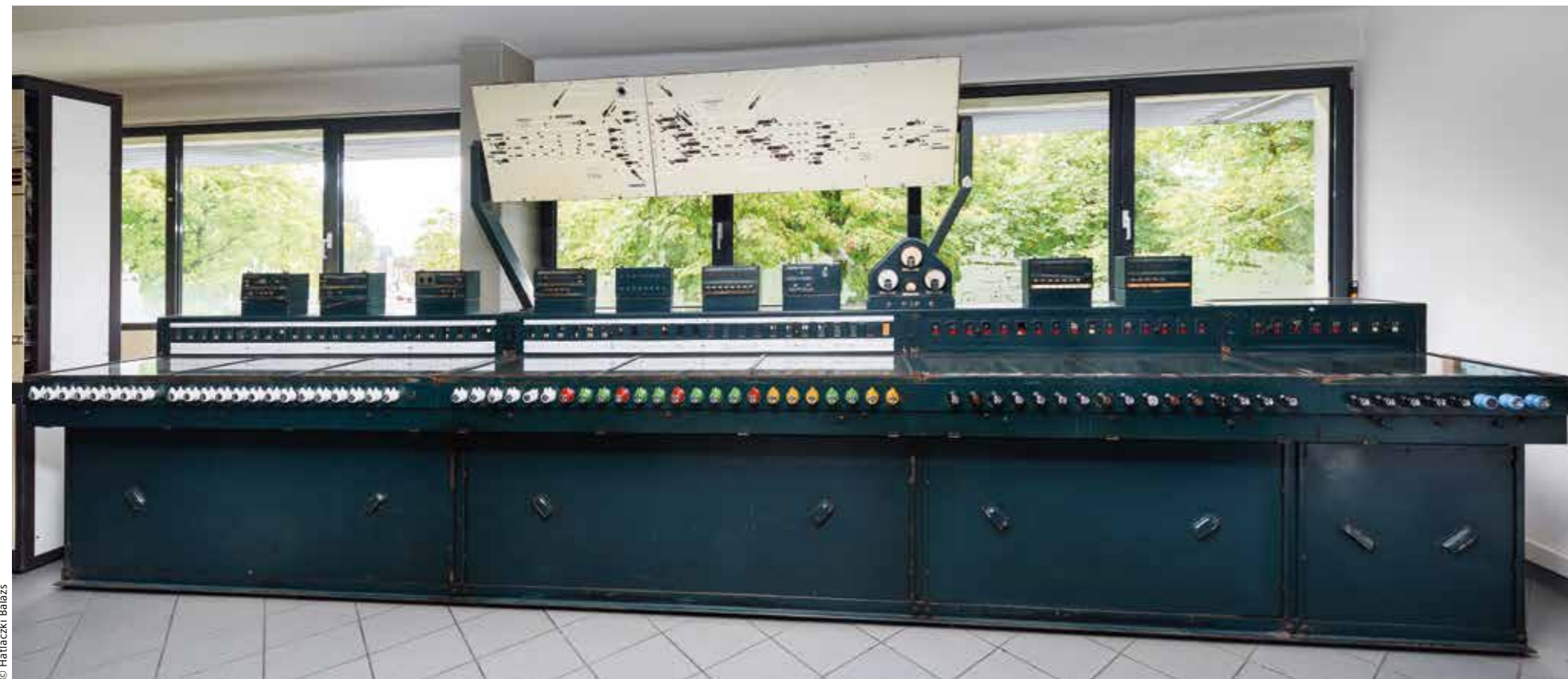
Siemens gyártmányú VES állomási elektroindinamikus biztosítóberendezés, amely a Komáromi vasúti állomáson működött 1936 és 2007 között (Vasúttörténeti Park)
