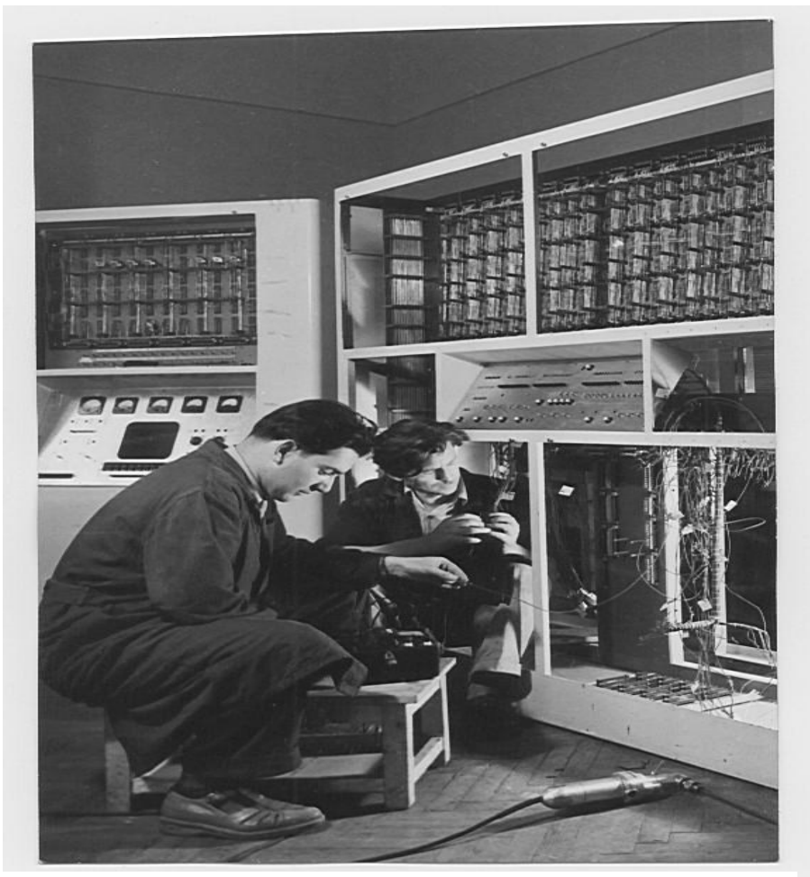
AZ ELEKTROMOS SZERELÉS ELLENŐRZŐ MÉRÉSE. VASVÁRI GYÖRGY mérnök (balról), az elektromos szerelés vezetője, és JUHÁSZ VIDOR technikus (jobbról)
